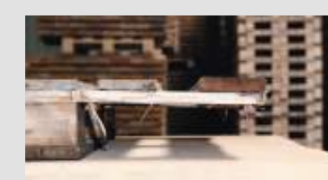
Brakujący element konstrukcyjny
